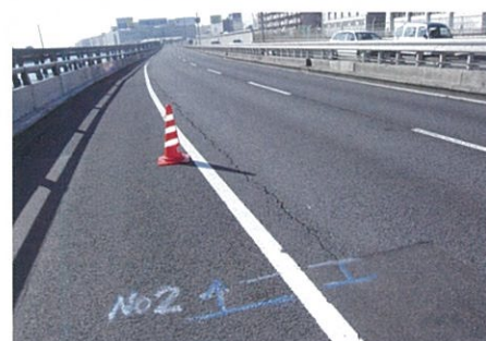
損傷状況(路面のひび割れ)
