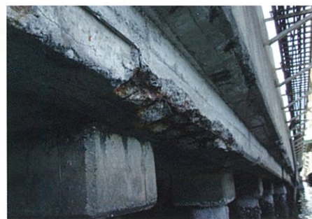
損傷状況(コンクリート剥離・鉄筋の腐食)
